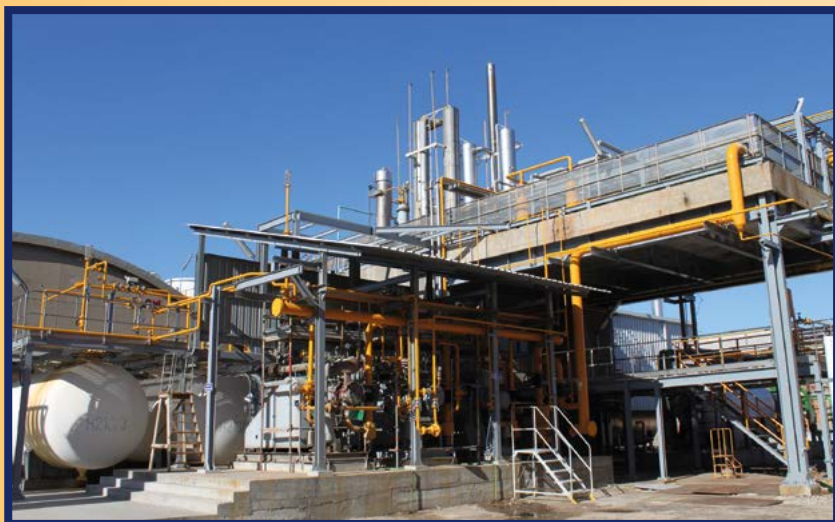
▲ Instalação de Hidrogénio
