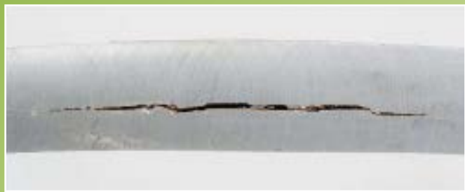
▲ Figura 2: Fissuração em tubagem de aço
